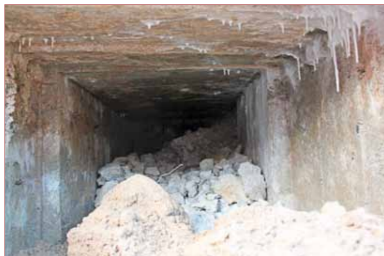
Fig. 2 : L'intérieur de l'abri bétonné rempli de gravats de démolition. Photo G.F.
