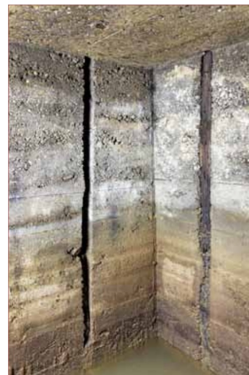
Fig. 8 : Angle du sous-sol. Les montants en bois du coffrage sont restés inclus dans les parois. Photo © Irwin Leullier
